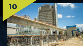
9 Pandangan kerja-kerja pemasangan kerangka bawah struktur besi sedang dijalankan bagi aras ruang legar Stesen MRT Jinjang.
