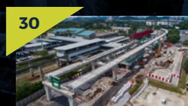
29 Kerja-kerja pelancaran galang kekotak berseghmen siap di tapak Stesen MRT Cyberjaya City Centre.
