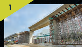
1 Pembinaan sistem penyangga untuk melancar galang kekotak bersegi berdekatan dengan Sekolah Antarabangsa IGB di Sungai Buloh.
