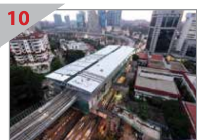
10 具有挑战性的工地 在繁忙的瑟曼丹路上方建设瑟曼丹捷运站。
