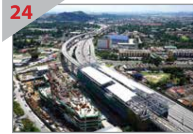
24 良好进展 斯里拉雅（Sri Raya）捷运站的站顶安装工程正在进行中。
