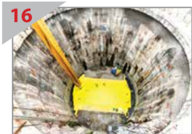
16 保持干燥 在回填前，依耐始发井内的隧道上方装置了防水膜。
