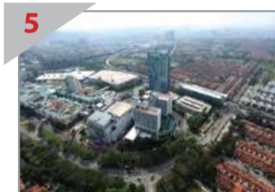
5 安装站顶 位于苏里安大厦隔壁的珍珠白沙罗捷运站正在安装站顶。
