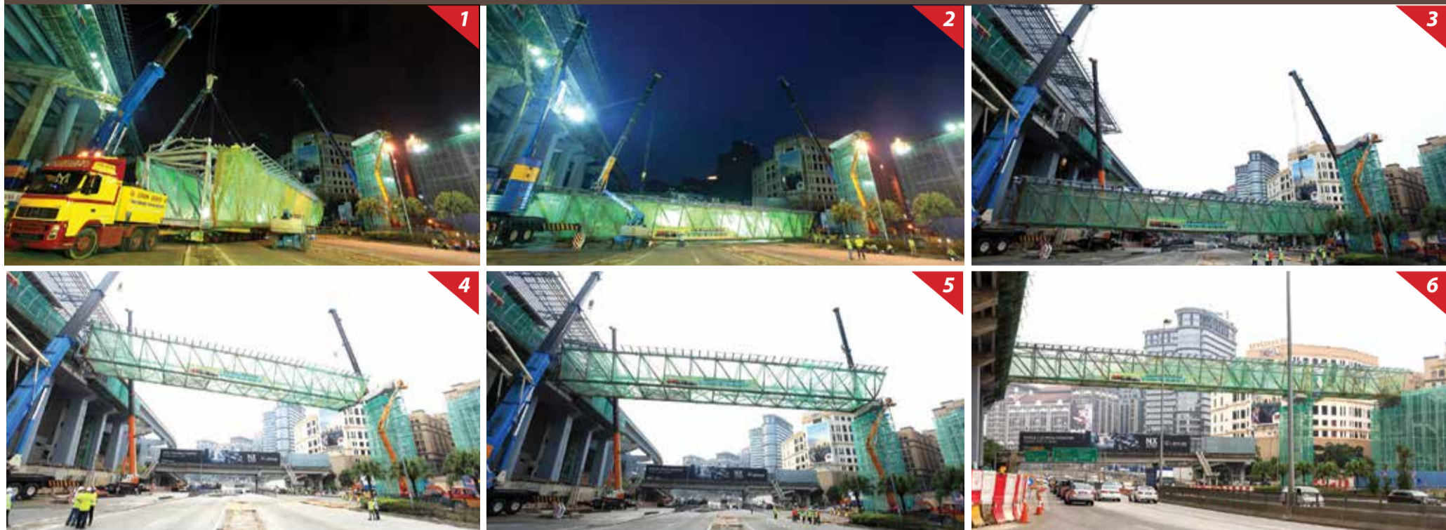
■ 建设Phileo Damansara捷运站行人天桥的工程在2015年9月5日傍晚开始。首先是把行人天桥的结构移动到正确位置（图1），以便进行吊升工程（图4-5）。接着，我们在2015年9月6日上午前把结构放置在捷运站和高架柱之间的位置上（图5）。在2015年9月23日，第二部分的桥段已安装于高架柱和捷运站入口建筑物之间（图6），完成了桥梁的结构。
