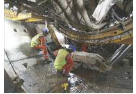
KETEPATAN • Pekerja-pekerja meletakkan satu segmen bagi membentuk lapik gelang terowong. Segmen ini diangkat dan dipasang oleh penegak segmen TBM.
