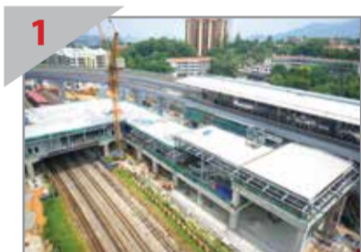
1 PERHUBUNGAN BAIK: Kerja pembinaan sedang dijalankan bagi jejantas bersama antara Stesen Komuter KTM (kiri) dan Stesen MRT Sungai Buloh (kanan).
