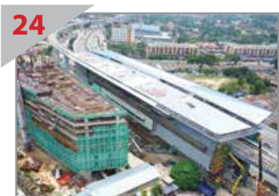
24 KERJA YANG BAIK: Pandangan kerja-kerja pembinaan di Stesen Sri Raya. Pembinaan di sebelah stesen adalah projek pembangunan persendirian.
