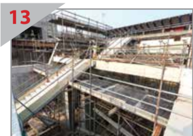
13 INTEGRASI AKAN DATANG: Pandangan tangga dan ruang untuk eskalator akan datang yang akan menghubungkan Stesen MRT Pasar Seni dan Stesen LRT Pasar Seni.
