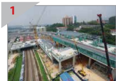
1 PENGHUBUNG Ruang legar bersepadu Stesen KTM Sungai Buloh (bumbung merah) dan Stesen MRT Sungai Buloh sedang dibina.
