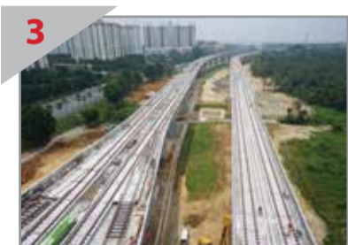
3 SEDANG DIBINA Kerja-kerja pemasangan trek di atas jejambat sepanjang Jalan Subang-Sungai Buloh dalam pelbagai peringkat pembinaan.
