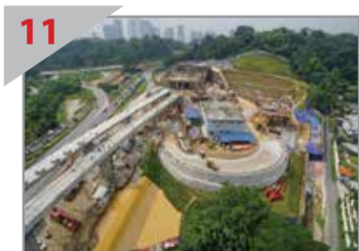
11 PENGHUJUNG UTARA Pandangan Portal Semantan, iaitu penghujung utara terowong MRT, di mana bangunan portal sedang dibina.
