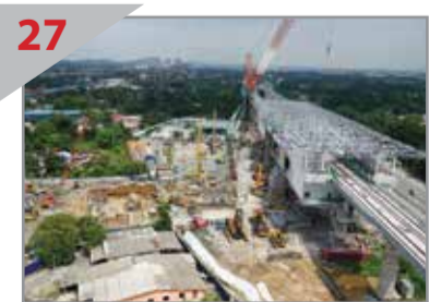
27 KEMAJUAN BAIK Pandangan Stesen Bukit Dukung (kanan) yang sedang dipasang bumbung. Di sebelah kirinya adalah tapak pembinaan bangunan tempat letak kereta bertingkat.
