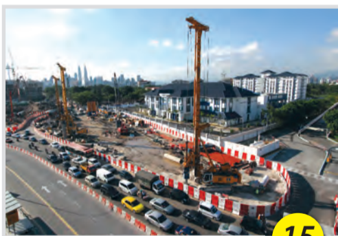
TAPAK PEMBINAAN SIBUK Kerja-kerja memantapkan cerucuk besi sedang dijalankan di lokasi Stesen MRT Maluri di hadapan Ibu Pejabat Polis Daerah Cheras.
