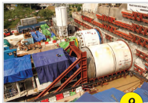
BERSIAP SEDIA Pandangan dua buah mesin pengorek terowong Earth Pressure Balance di Portal Semantan. Mesin yang di bahagian hadapan gambar memulakan kerja-kerja penggalian terowong pada pertengahan bulan Jun manakala yang kedua bermula sebulan kemudian.
