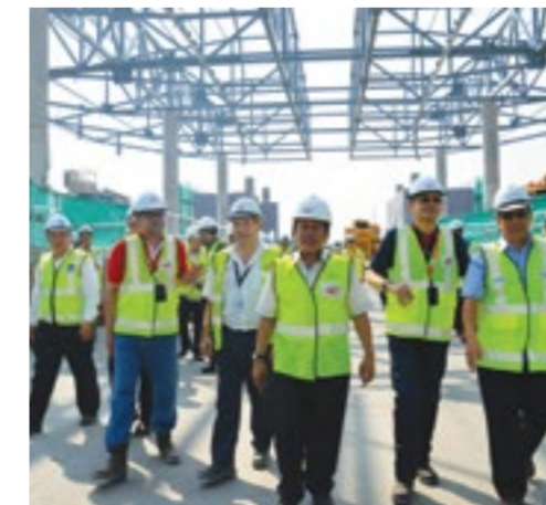
■ LAWATAN KE STESEN • Datuk Ahmad Maslan (tengah) berjalan di atas jambatan bertingkat di mana beliau menyaksikan kerja pemasangan landasan bagi laluan utama MRT Sungai Buloh-Kajang.
