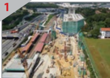
1 KEMAJUAN YANG BAIK Pandangan pembinaan Stesen MRT Sungai Buloh (hadapan) dan kemudahan parkir bertingkat "Park and Ride" Sungai Buloh (belakang).
