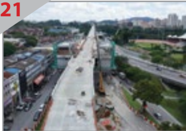
21 LOKASI YANG BAIK Stesen MRT Taman Pertama yang sedang dalam pembinaan terletak di hadapan kawasan komersial.
