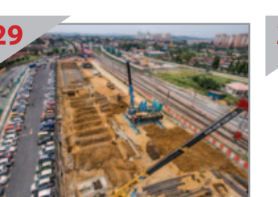
29 KEMUDAHAN MASA HADAPAN Pandangan tapak kerja bagi kemudahan parkir bertingkat "Park and Ride" di Stesen MRT Kajang yang akan datang (tengah) dan tempat letak kereta sementara (kiri).
