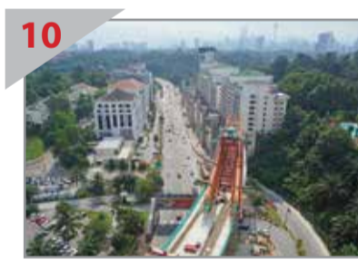
10 DALAM PEMBINAAN Gantri pelancar sedang membina jambat MRT di sepanjang Jalan Semantan.
