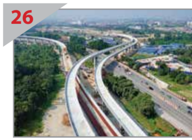
26 BERGAYA Pandangan jambat MRT yang telah siap bagi laluan utama (kiri) di sepanjang Lebuhraya Cheras-Kajang dan laluan sokongan menuju ke Depoh Kajang (kanan).
