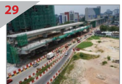
29 STESEN BARU Pembinaan Stesen Sungai Kantan di atas Jalan Cheras sedang dijalankan.
