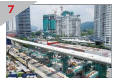
7 MENGAGUMKAN Pembinaan jambat dan Stesen Taman Tun Dr. Ismail di sepanjang Jalan Damansara di Taman Tun Dr. Ismail.
