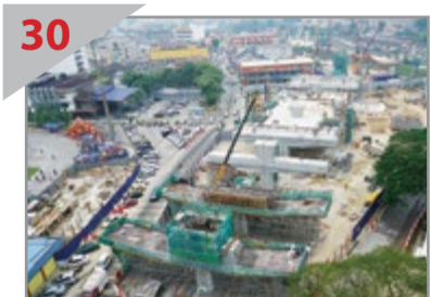
30 PEMBINAAN RANCAK BERJALAN Pandangan udara pembinaan Stesen Bandar Kajang bersebelahan Stadium Kajang.
