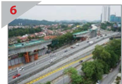
6 MENGHUBUNGAN LALUAN Rentang khas jambat MRT sedang dibina di sepanjang Lebuhraya Damansara-Puchong (LDP) di Taman Tun Dr. Ismail.
