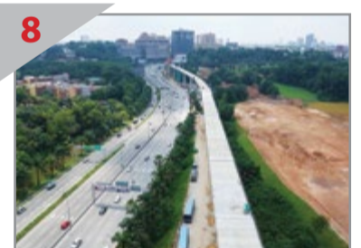
8 TAPAK KERJA YANG INDAH Jambat MRT yang telah siap dibina di sepanjang Lebuhraya SPRINT bersebelahan Kelab Golf Perkhidmatan Awam (KGPA).
