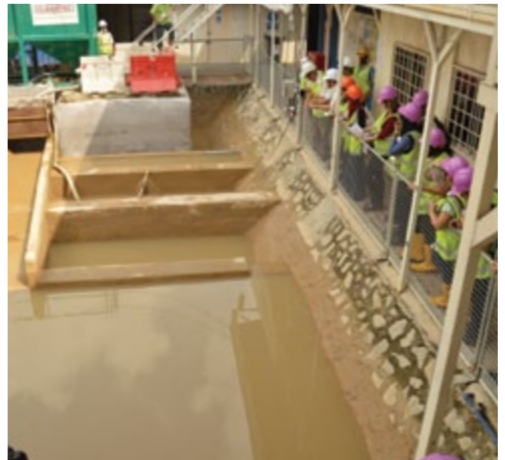
■ 媒体人员在中央艺术坊捷运站工地，观察工地如何在排出废水前，先净化与滤除水里的淤泥。
