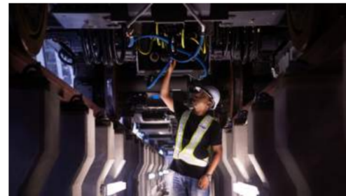
■ PEMERIKSAAN MENYELURUH: Seorang jurutera menjalankan pemeriksaan ke atas pengkabelan dan penyaluran di bahagian bawah tren di Depoh Sungai Buloh. Gambar oleh Siemens AG.
