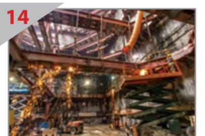
14 TAPAK KERJA YANG SIBUK Kerja membuka lubang-tupang yang menyokong dinding-dinding diafragma bagi kekokat Stesen Merdeka sedang dijalankan.
