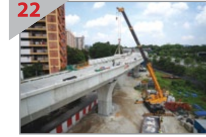
22 KEMAJUAN MENGGALAKKAN Pemasangan parapet sedang dijalankan di sepanjang seksyen jambat yang telah selesai di Flat Sri Sabah.
