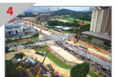
4 PERSIMPANGAN YANG SIBUK Pembinaan laluan bawah tanah sedang dijalankan di persimpangan Persiaran Surian-Jalan Mahogany.
