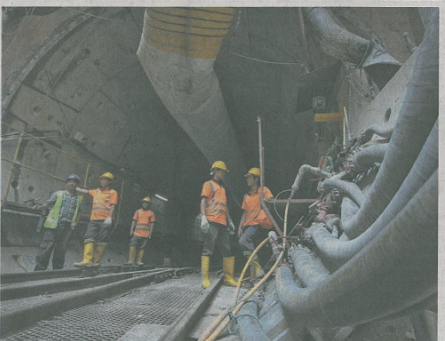
KERJA-KERJA pembinaan terowong bawah tanah di Jalan Alor, Bukit Bintang, Kuala Lumpur giat dilaksanakan.
