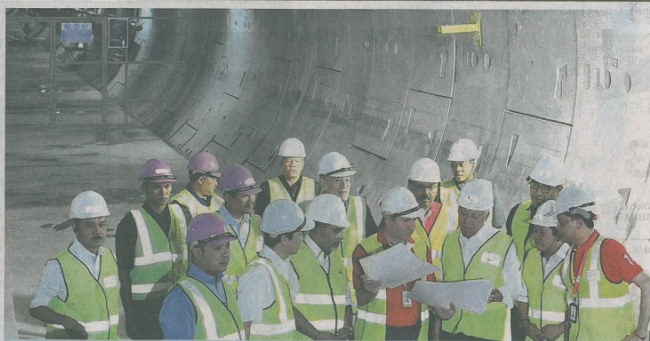
PERDANA Menteri, Datuk Seri Najib Tun Razak mendengar penerangan Pengarah Projek Mass Rapid Transit (MRT), Marcus Karakashian (lima kanan) ketika meninjau kerja-kerja pembinaan hub pengangkutan awam laluan bawah tanah MRT di Stesen Cochrane, baru-baru ini. Turut sama, Timbalan Menteri Kewangan Datuk Ahmad Maslan (tiga kanan) dan Shahril Mokhtar (dua kanan). - BERNAMA
