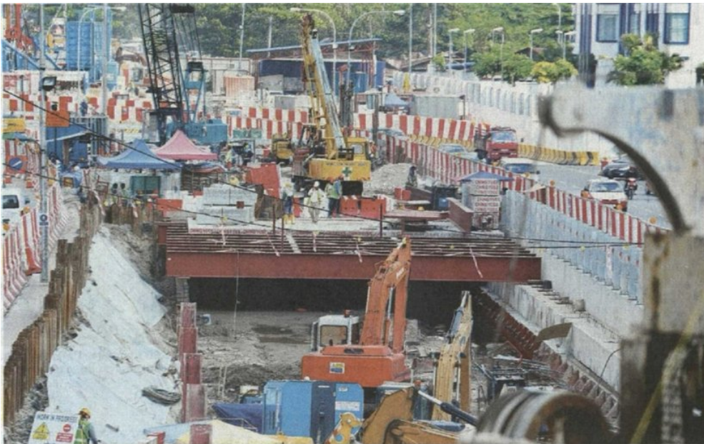
KERJA-KERJA pembinaan concrete decking di atas tapak Stesen MRT Maluri di Jalan Pudu Ulu, Kuala Lumpur yang terletak di bawah tanah sedang giat dijalankan. - UTUSAN/AZLIZA HAILANI
